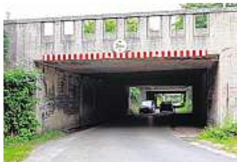
Die Sanierung der Bauwerke am Mähländsweg steht laut Bahnauskunft 2015 an.
