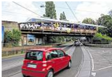
Die Eisenbahnbrücke über die Sebaldsbrücker Heerstraße ist ein Sanierungsfall.
